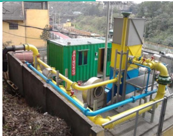
FIGURE 4. STATION DE DRAINAGE DE MÉTHANE À KHE CHAM
