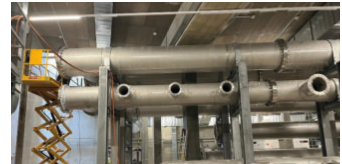
Équipements hydrauliques, thermiques et électriques pour la station d'échange du quartier PAV Projet Genilac, Suisse Études, supervision des travaux et assistance à la mise en service
