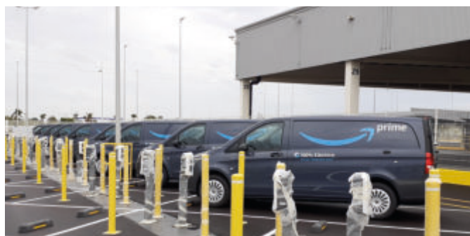
Installation de recharge du centre logistique – Espagne Études APS et APD des installations électriques pour plus de 280 points de recharge de véhicules électriques dans plusieurs centres logistiques et parkings Amazon en Espagne
