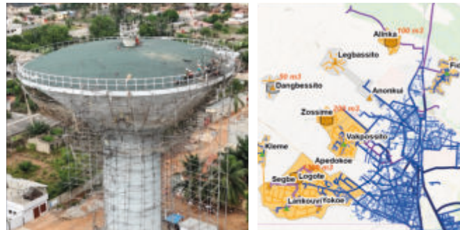
Projet d'eau potable pour la ville de Lomé : réservoirs et réseau d'adduction d'eau – Togo Étude préliminaire, études détaillées, passation des marchés, supervision des travaux et assistance à la mise en service
